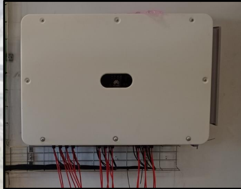
INVERSOR (opcional bateries)
